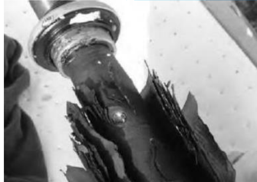
Dëmtimi i Izolatorit përcjellës - Bushing
